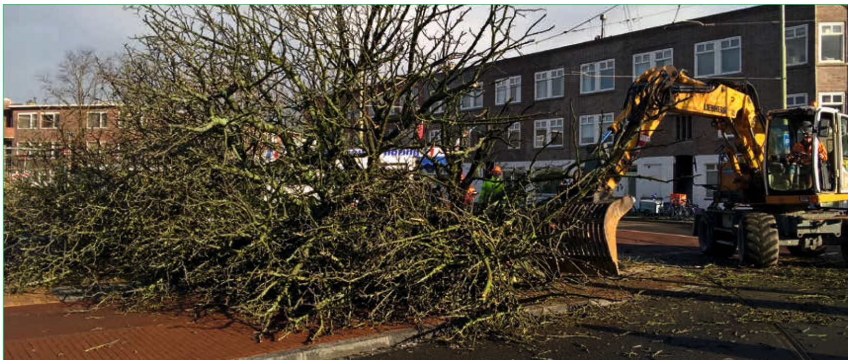
Stormschade. Foto: gemeente Den Haag.
